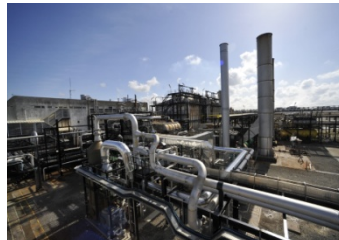
Total Lacq Frankreich - 30 MW th Oxy - Gas/Öl
